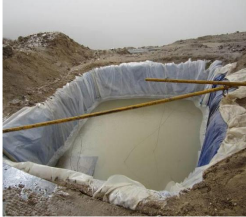
施工废水回用
